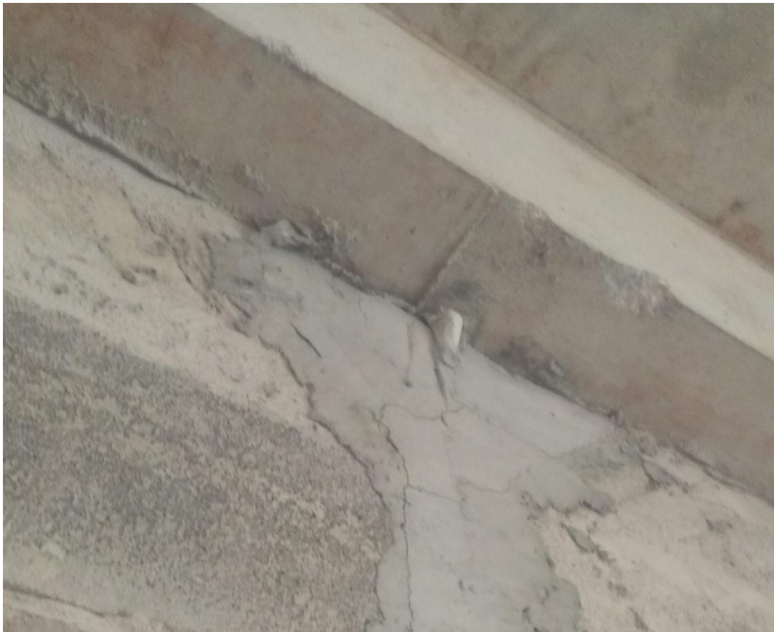
3. 厨房窗上部过梁出现预埋线管（此处不应该有）
