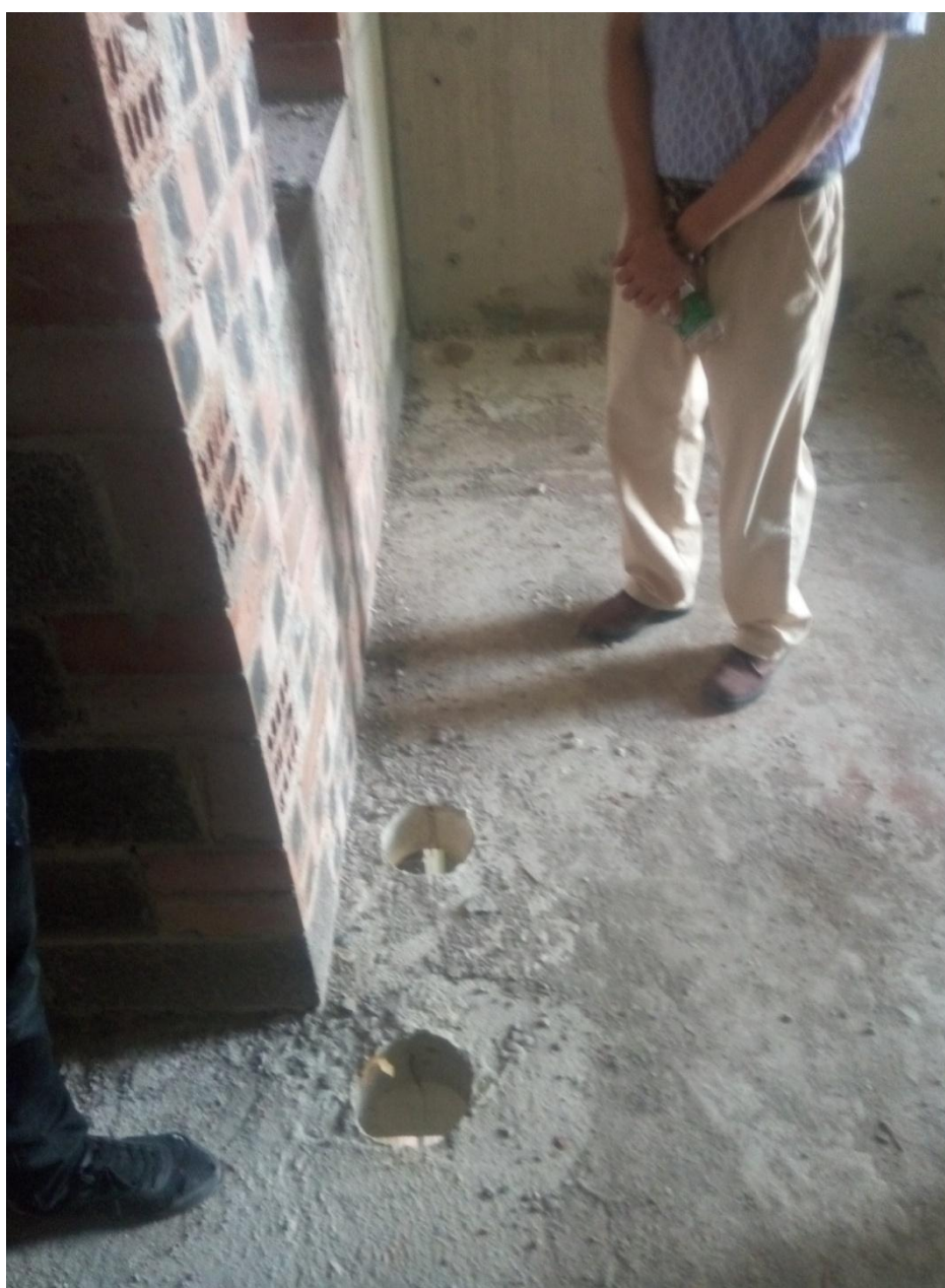
7. 墙体砌块砌筑仍有不规范之处
