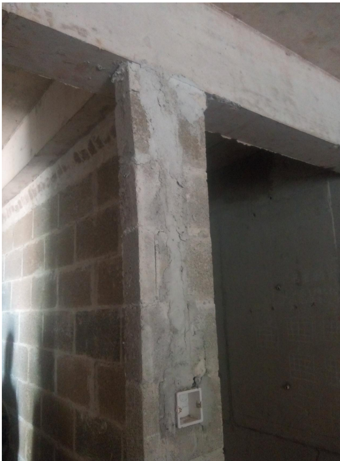
2. 预埋线管时，没有熟悉墙体砌筑位置，致使线管偏位
